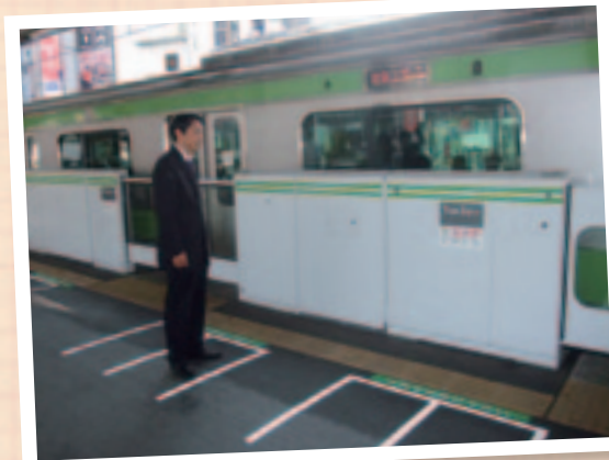
事故防止「命を守るホームドア」を設置 (写真は JR 高田馬場駅・その他 JR 白駅等)
